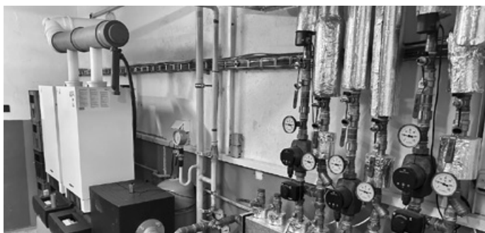
V současné době jsou větší kotelny v majetku města relativně nové. Po první rekonstrukci kotelny na základní škole před rokem 2022 následovala výměna kotlů v mateřské škole a na radnici. Nové kotle pro otopnou soustavu jsou i v budově zdravotního střediska a na bytovém domě B. Němcové.
