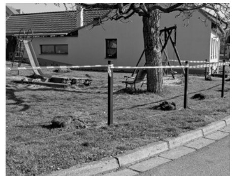
Dětské hřiště na ulici Čechova během budování nového plotu. Nyní je bezpečnější a těší se na nové certifikované prvky.
