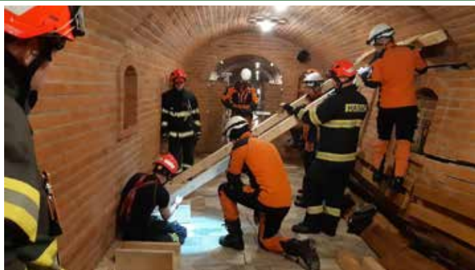
Náročný zásah místních hasičů – zabezpečení bortícího se vinného sklepa
