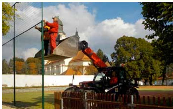
Výměna pletiva na plotě oddělujícím sportovní a dětskou část hřiště za kostelem
