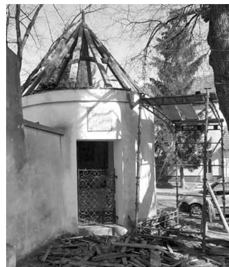
Odkrytá střecha nárožní kaple u vstupní brány na hřbitov.
