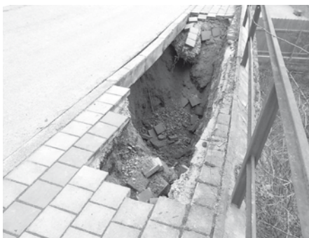
Propadlý chodník na ulici V Údolí.
