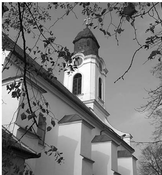
Střecha barokního kostela Nanebevzetí Panny Marie ve Velkých Pavlovicích volá po opravě.
