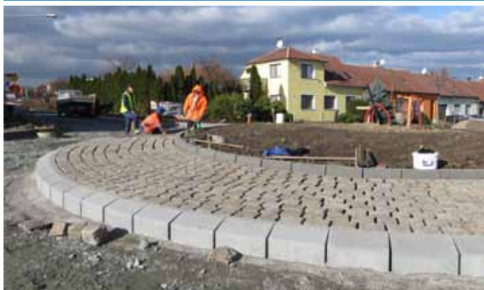
Kruhový objezd na křižovatce ulic Brněnská, Dlouhá a Za Dvorem byl vydlážděn původními žulovými kostkami
