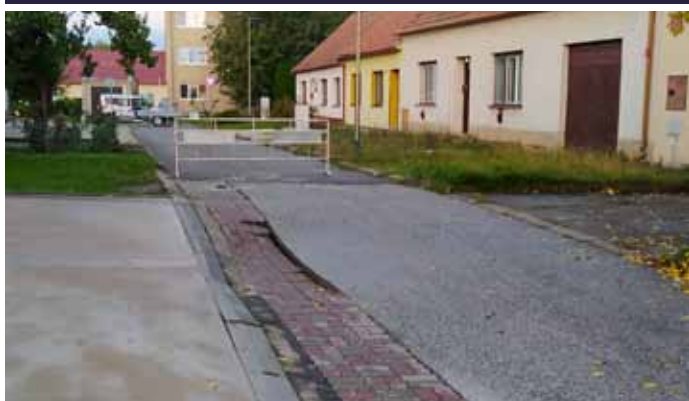
Propadlá vozovka nad sklepními prostory v ulici Horní
