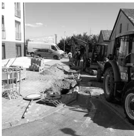
Porucha na kanalizačním vedení – Tovární ulice.
