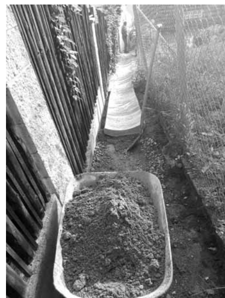
Budování odtokového žlabu na ulici V Údolí. Pozor – nepleťte si jej s chodníkem!!!
