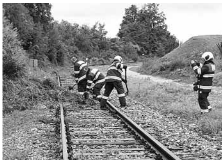
Hlína a bahno na kolejích nedaleko místní vlakové zastávky – výsledek nepřetržitého nočního přívalu srážek.
