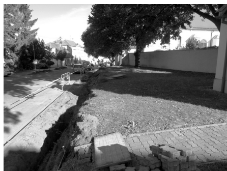
Přípravné práce na vybudování nových parkovacích ploch mezi kostelem a hasičskou zbrojnicí.
