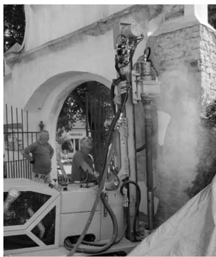
Oprava hřbitovní brány spočívá ve statickém zajištění, které zabrání dalšímu naklání.
