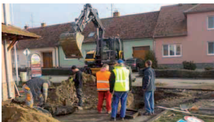
Porucha kanalizace na ulici Dlouhá před Vinařstvím V&M Zborovský
